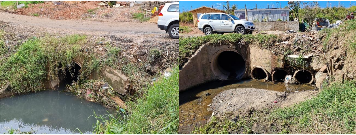
Figura 8 (a e b) - Aspecto da entrada das tubulações que conduzem o rio por baixo da linha férrea. Foto (a) dia 04 de março em meia vazão e foto (b) dia 18 de maio em estiagem.
