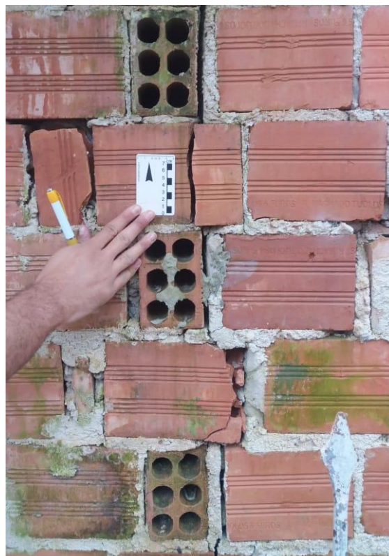
Figura 2 - Rachadura na construção localizada no terreno em que houve a formação da dolina. Observa-se uma abertura de 1 cm e que atravessa as juntas de concretos e os blocos da parede da casa.
