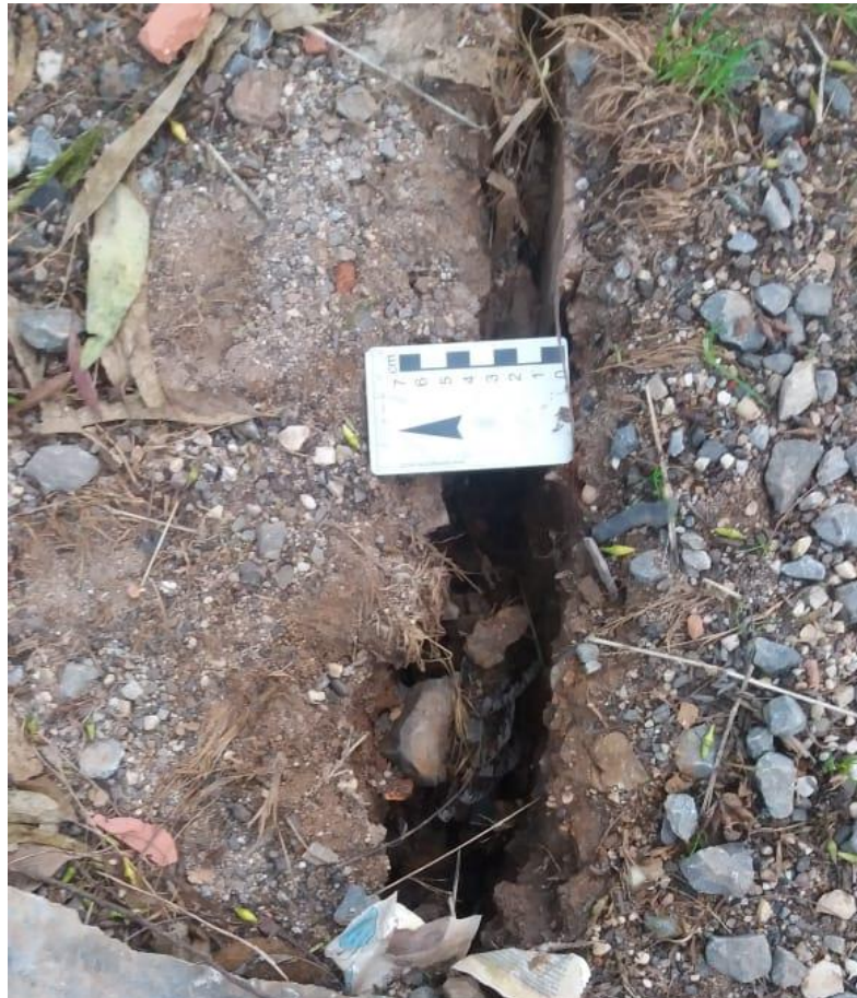
Figura 7 - Fenda de tração no topo do maciço com mais de 5cm de abertura
