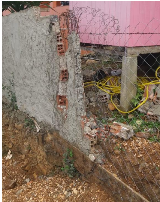
Figura 4 - Muro vizinho que foi derrubado na parte frontal, afetado diretamente pela formação da dolina.
