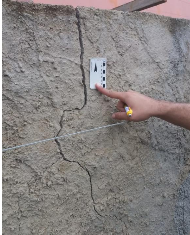
Figura 3 - Rachadura no muro vizinho ao terreno em que se formou a dolina, observa-se variação na abertura da rachadura, com possível movimentação do solo associada. A maior abertura, no topo, é de 1,5 cm, já na base, cerca de 5 mm.
