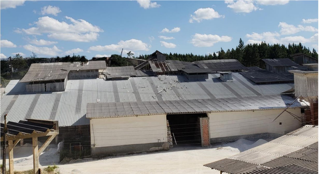
Figura 13 – Barracões da Mineração Fiorese. Em primeiro plano está o telhado já reparado conforme demonstram as telhas novas de substituição. Em segundo plano telhado mostrando os impactos do vento, ainda para ser reparado.
