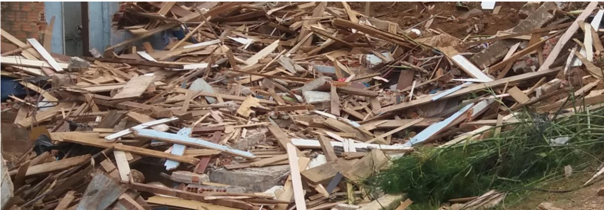
Figura 6 – Rua José Elias. Observe os escombros em quantidade constituídos principalmente por madeiras, tábuas e painéis.
