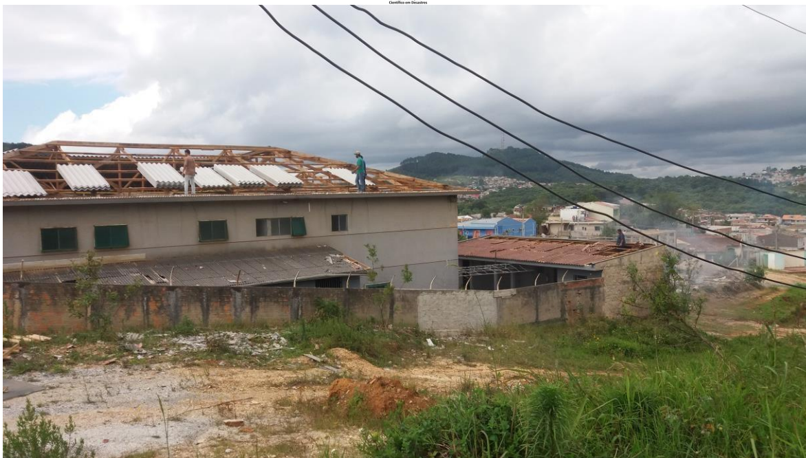
Figura 4 – Imagem de edifício atingido com destaque para os danos no telhado que exigiram recuperação total.
