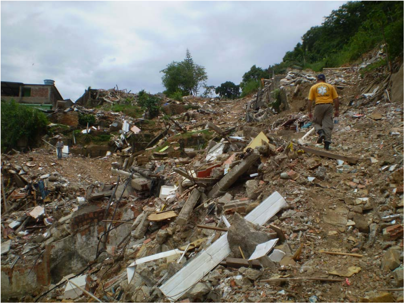
Ilustração 6: Resíduos de demolição que exigem atenção para não agravarem o cenário.
