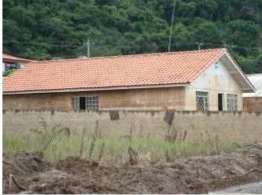
Figura 4 – Casa atingida por inundação
