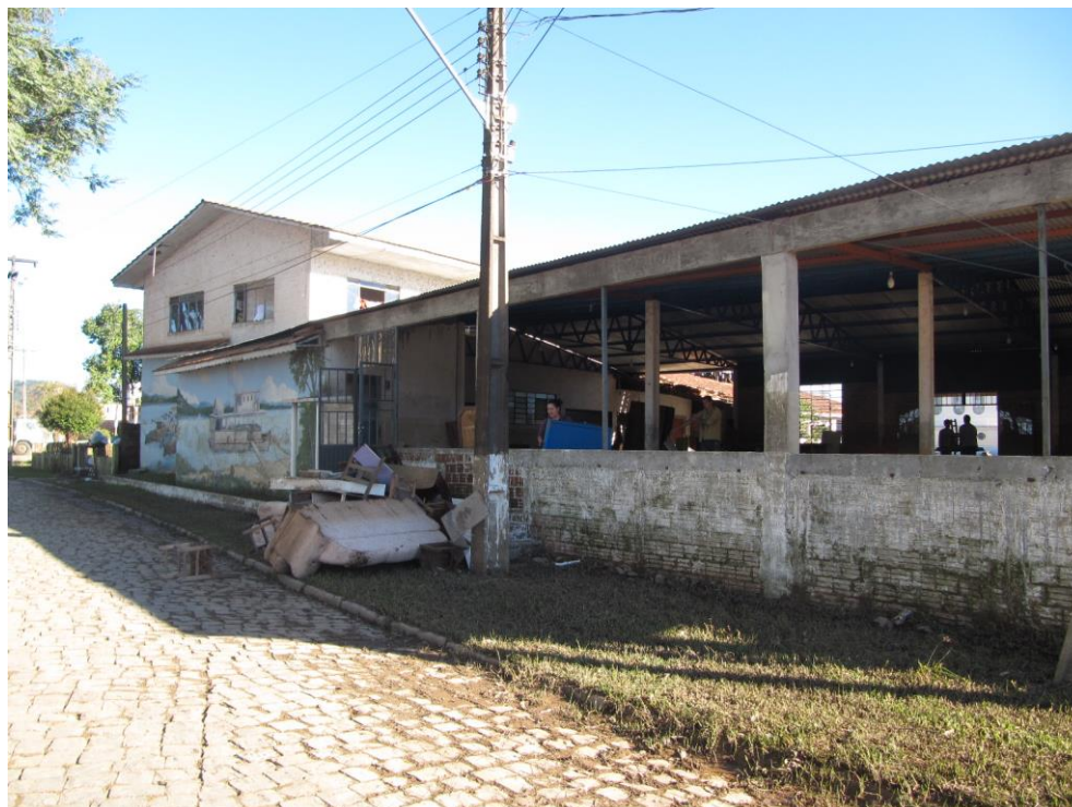
Figura 09: Pavilhão da Igreja do Bairro Navegantes, inundação de até 2 m de altura.
