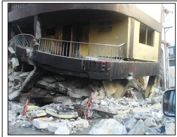
Figura 01: Prédio afetado pelo cismo onde se observa o pavimento inferior colapsado
